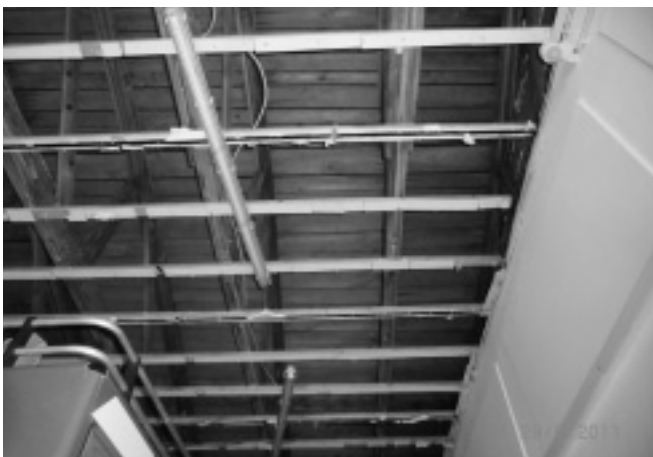
Der alte sanierungsbedürftige Dachstuhl
